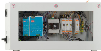
** Integrierte Steuerung mit Schaltschrank Integrated control system with switch cabinet
